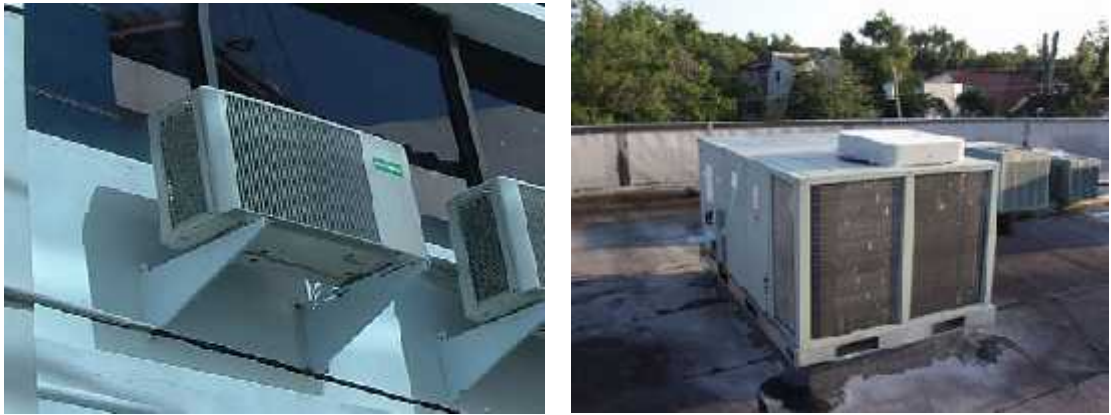
Gambar.1.4 Kondensor yang diletakan di luar ruangan (out door)
