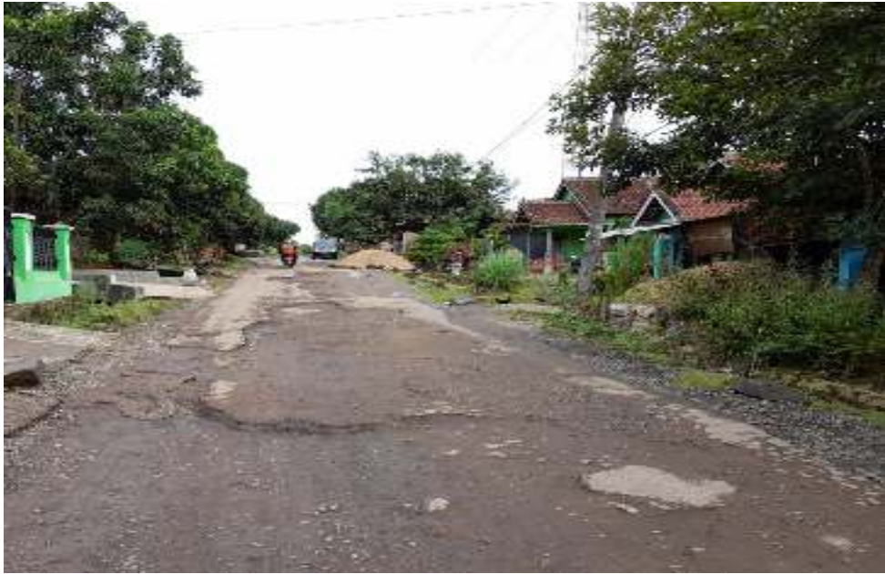
Kondisi Jalan Yang Akan di Perbaiki
