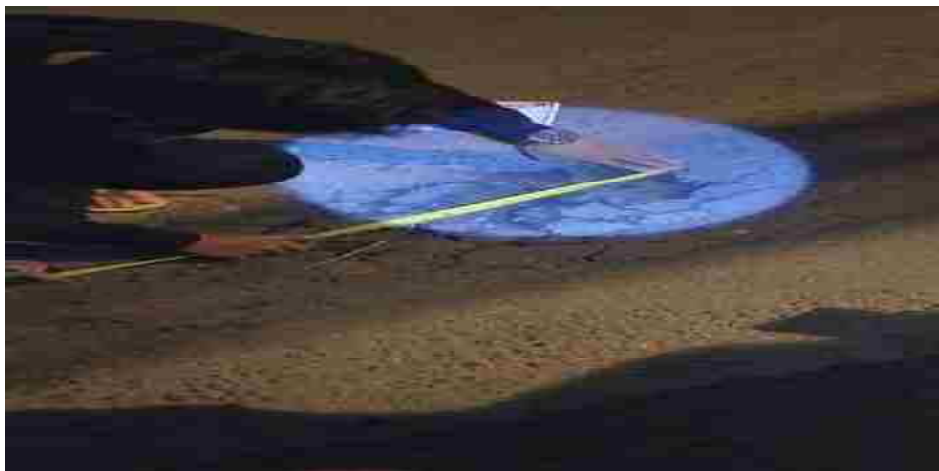
Gambar 4.4. Kerusakan Corrugation Jalan Pulau Damar, Bandar Lampung.
