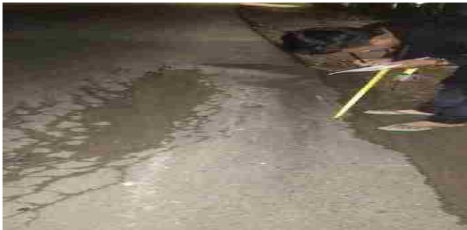
Gambar 4.50. Kerusakan Alligator Cracking di Jalan Pulau Damar, Bandar Lampung.
