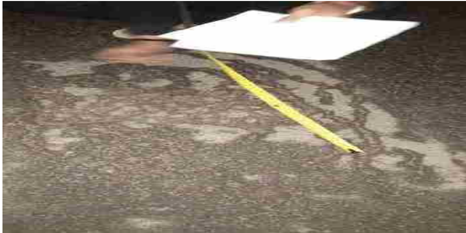
Gambar 4.27. Kerusakan Alligator Cracking di Jalan Pulau Damar, Bandar Lampung.
