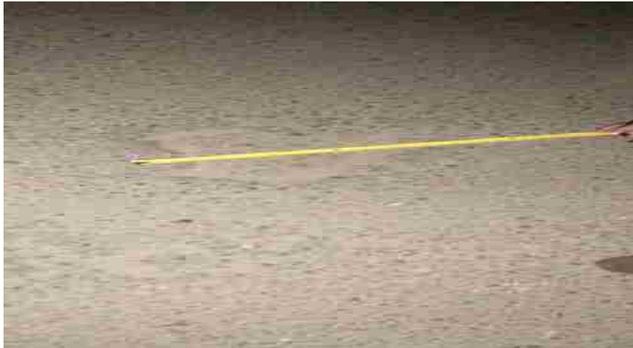
Gambar 4.3. Kerusakan Corrugation Jalan Pulau Damar, Bandar Lampung.
