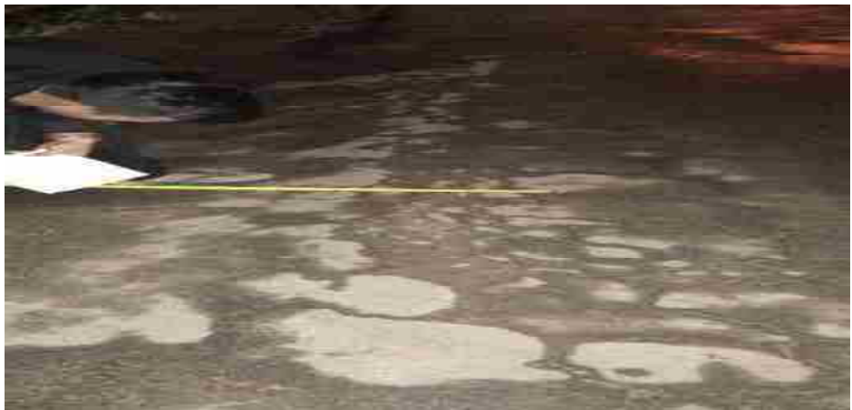
Gambar 4.48. Kerusakan Alligator Cracking di Jalan Pulau Damar, Bandar Lampung.
