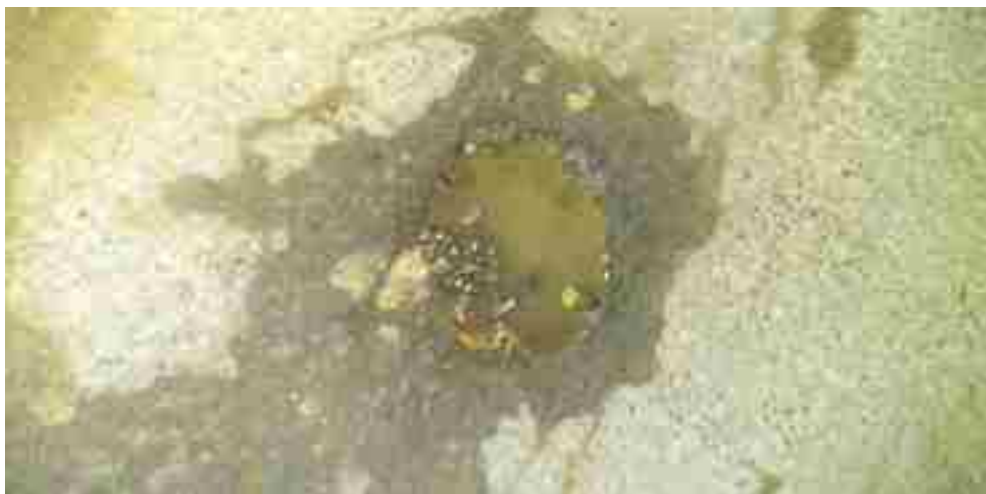
Gambar 4.34. Kerusakan Defression di Jalan Pulau Damar, Bandar Lampung.
