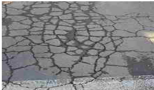
Gambar 2.1. Kerusakan Alligator Cracking
