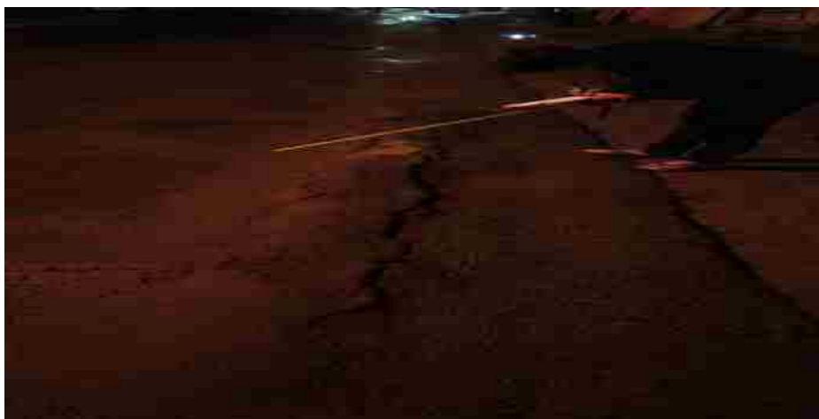
Gambar 4.44. Kerusakan Aligator Cracking di Jalan Pulau Damar, Bandar Lampung.
